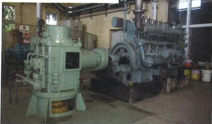
川中島終末処理場雨水ポンプ （茂原市）
